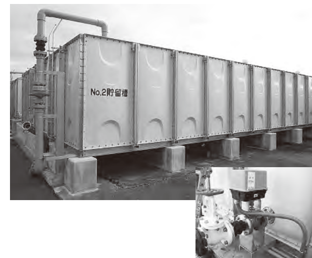
緊急遮断弁システム
